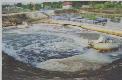
PEMANDANGAN keseluruhan kolam maturasi yang telah dinaik taraf menggunakan sistem bersepadu Phytogreen, separator dan incline clarifier.
